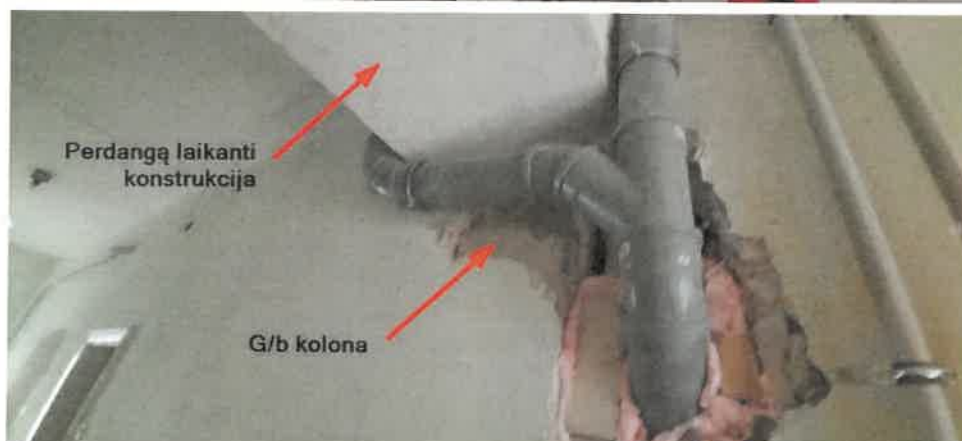
2 pav. tęsinys. Defektų fotofiksacinė medžiaga: 5-7) trūkimai pertvarinėse sienose, 8) laikančios konstrukcijos
